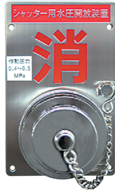
送水口表示板 Water feed port nameplate
