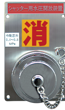
送水口表示板
