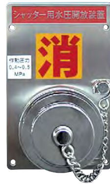
送水口表示板 Water feed port nameplate
